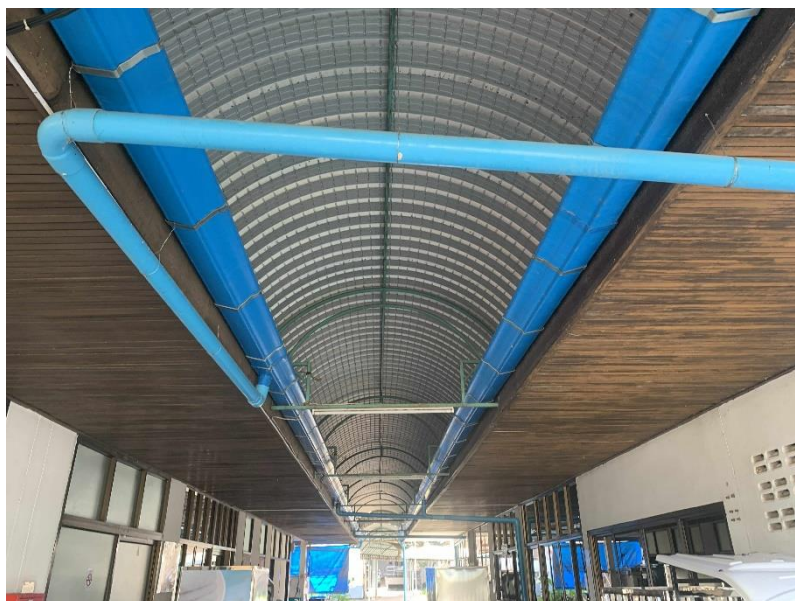
มีรางระบายน้ำฝนออกจากตัวอาคาร
