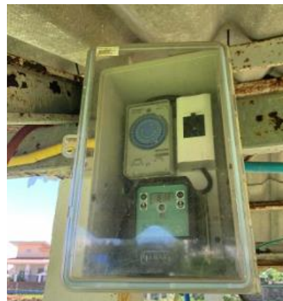
ตู้ควบคุมการเติมคลอรีน
