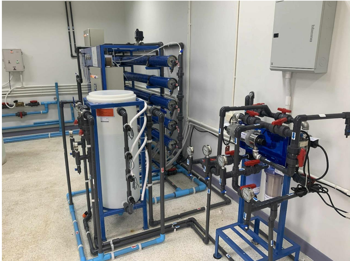
ระบบการผลิตน้ำ REVERSE OSMOSIS อาคารไต้เทียม
