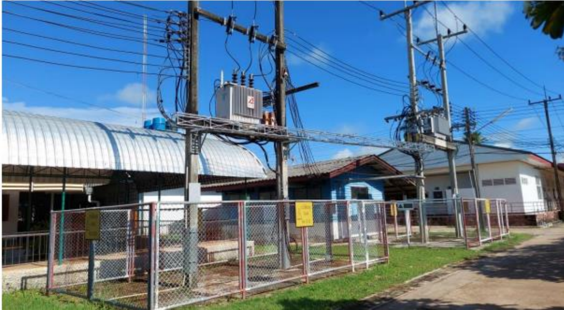
หม้อแปลงไฟฟ้า 2 ขนาด
