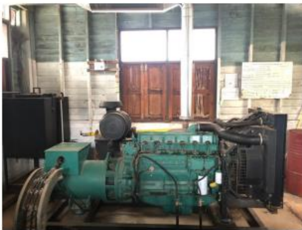
เครื่องกำเนิดไฟฟ้าสำรองขนาด 125/100 kVA/kW ยี่ห้อ Volvo Penta
