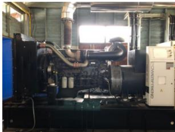
เครื่องกำเนิดไฟฟ้าสำรองขนาด 400/320 kVA/kW ยี่ห้อ Iveco Gen Meccalte
