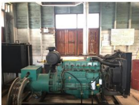
เครื่องกำเนิดไฟฟ้าสำรองขนาด 125/100 kVA/kW ยี่ห้อ Volvo Penta
